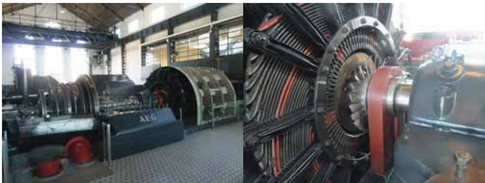
Bild 5: Links einer der Generatoren des Kraftwerks mit Turbine, rechts der Rotor zur Erzeugung des Magnetfeldes.
