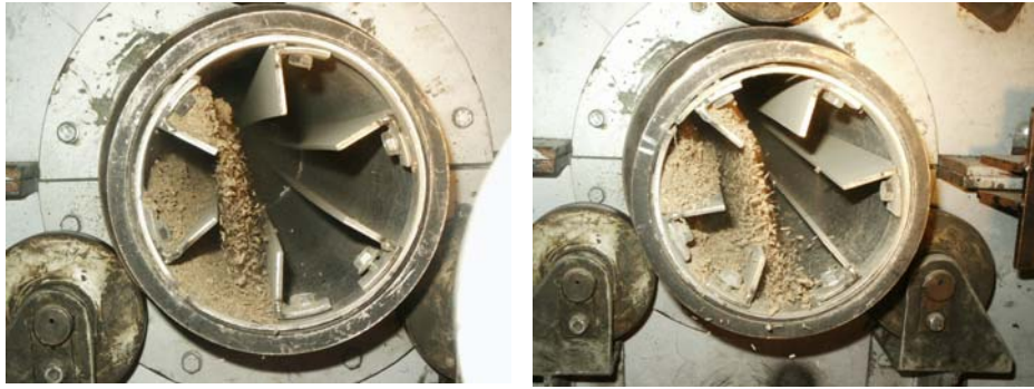
Bild 5.31 Blick in das Drehrohr mit Wendeblechen
