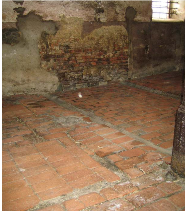
Abb.9: Beispiel für eine nicht zu reinigende bzw. zu desinfizierende Mastbucht mit unebenem Boden, Löchern zwischen den Fugen und abgeblättertem Putz von den Wänden
